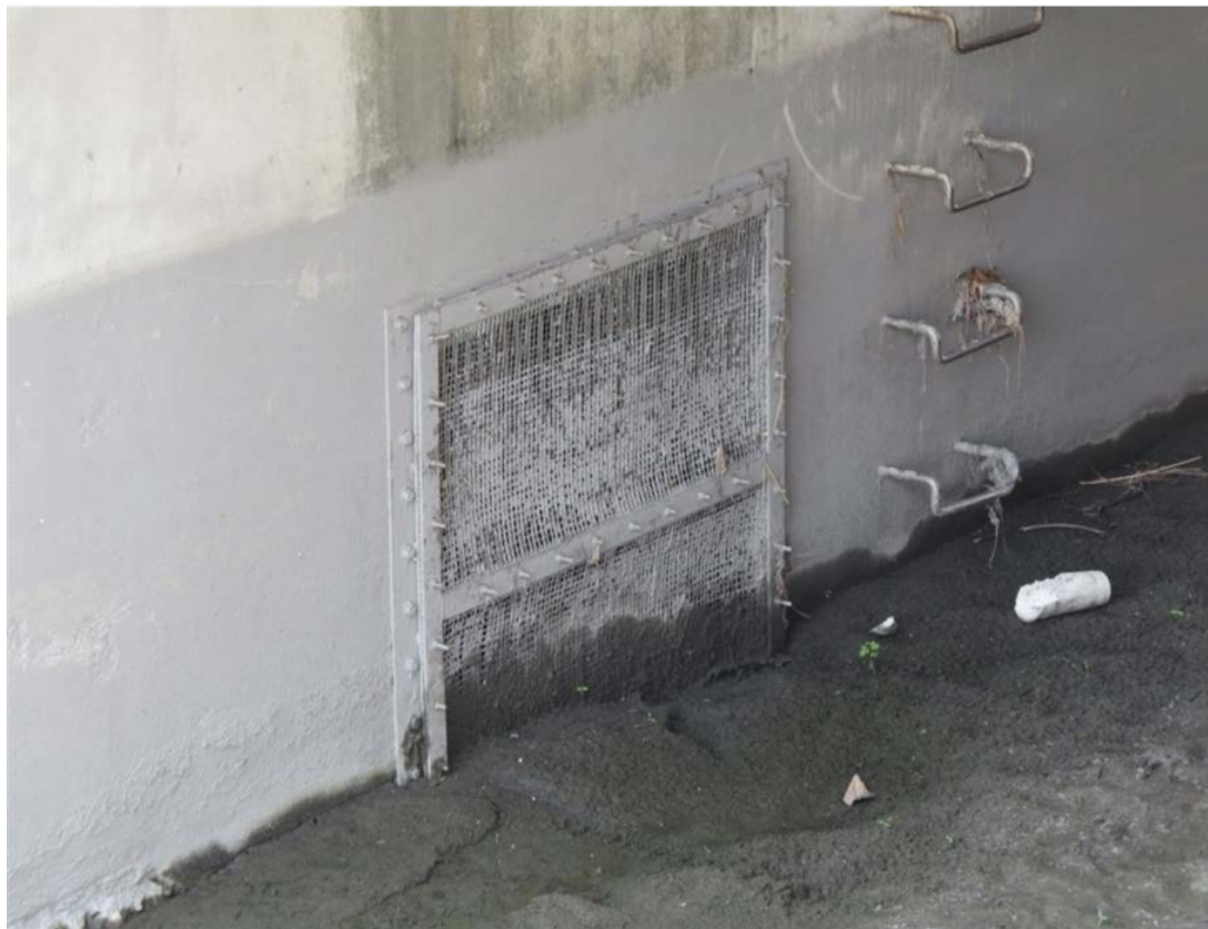
圖 8 本場 105 年 7 月 29 日東海排水截流進水口遭污泥堵塞（資料來源：臺東縣審計室。）
