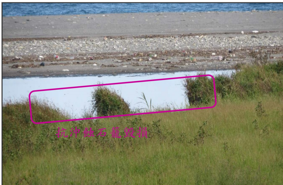
圖 5 104 年 10 月 1 日本場生態池抗沖蝕石籠毀損（資料來源：臺東縣審計室。）
